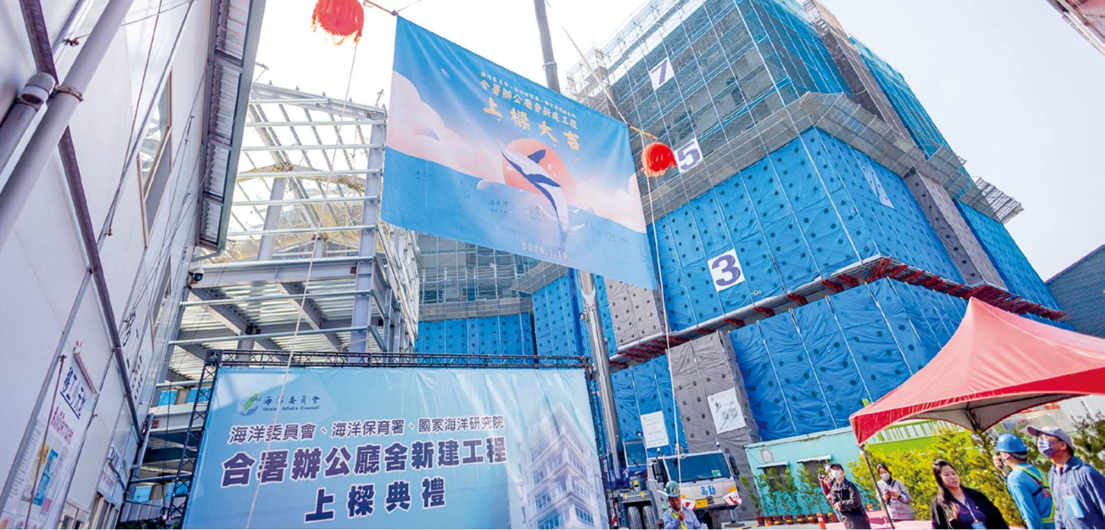
工程單位將樑柱安放入建築主結構中，圓滿完成上樑典禮。
